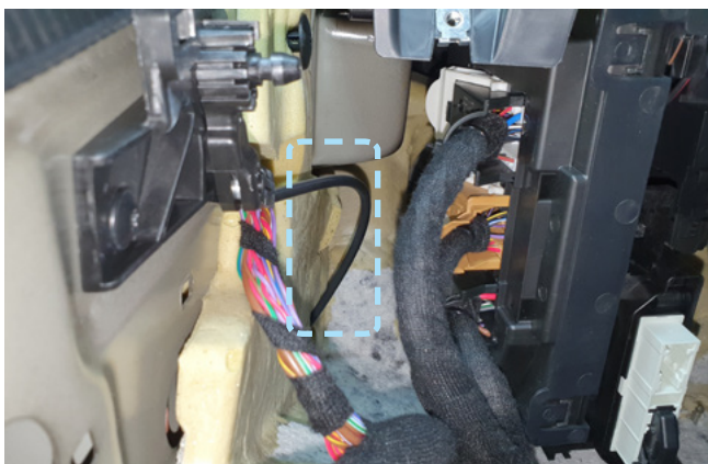
Фото 2.7. Пример расположения центрального блока охранно-телематического комплекса
